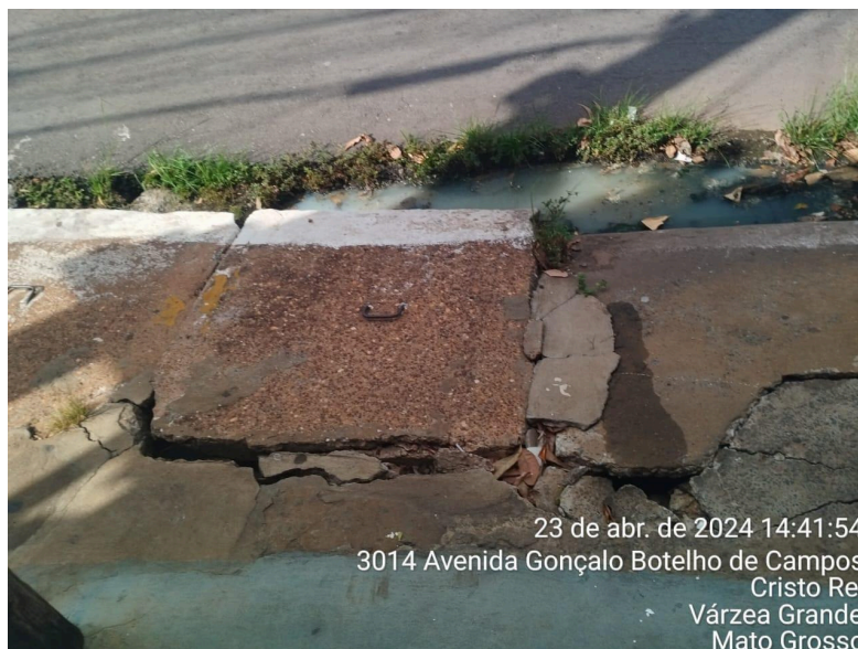
Figura 3. Boca de lobo que necessita de reforma.
