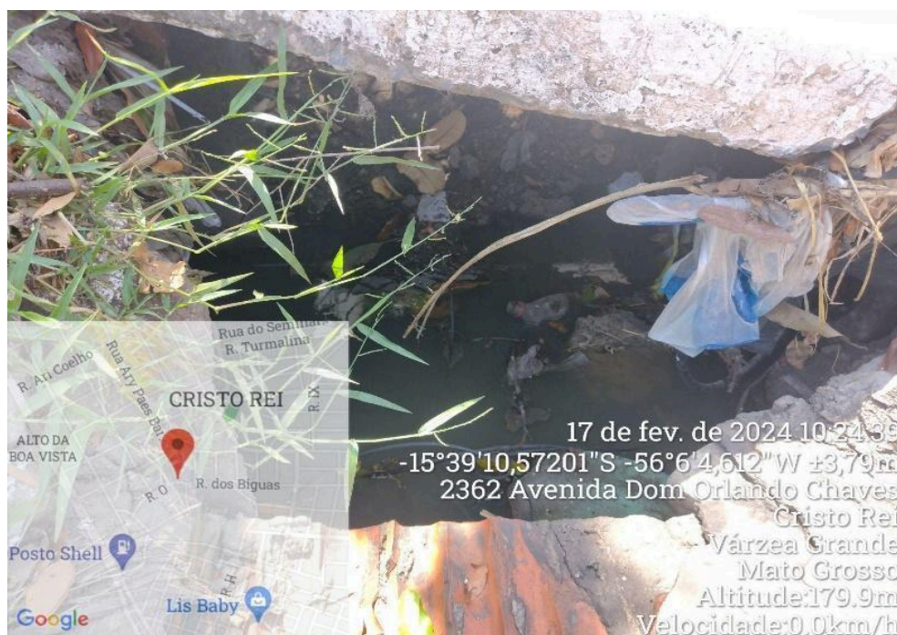
Figura 5. Boca de lobo que necessita de manutenção geral.
