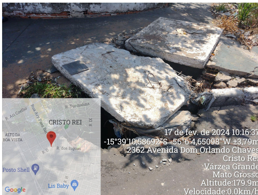
Figura 4. Boca de lobo que necessita de manutenção geral.
