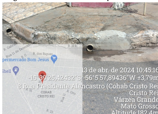
Figura 16. Boca de Lobo alterada por moradores
