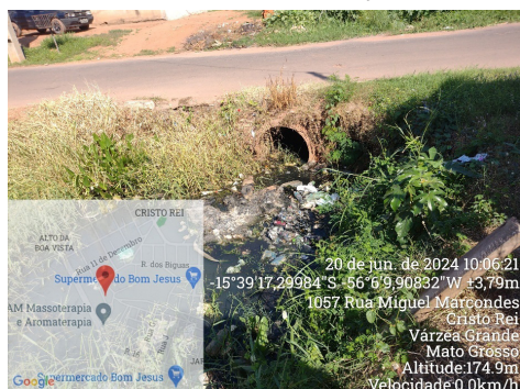
Figura 14. Córrego do Jacaré com presença de esgoto e resíduos
