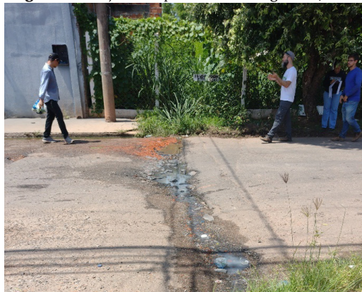
Figura 25. Sarjetão improvisado na Lagoa do Jacaré
