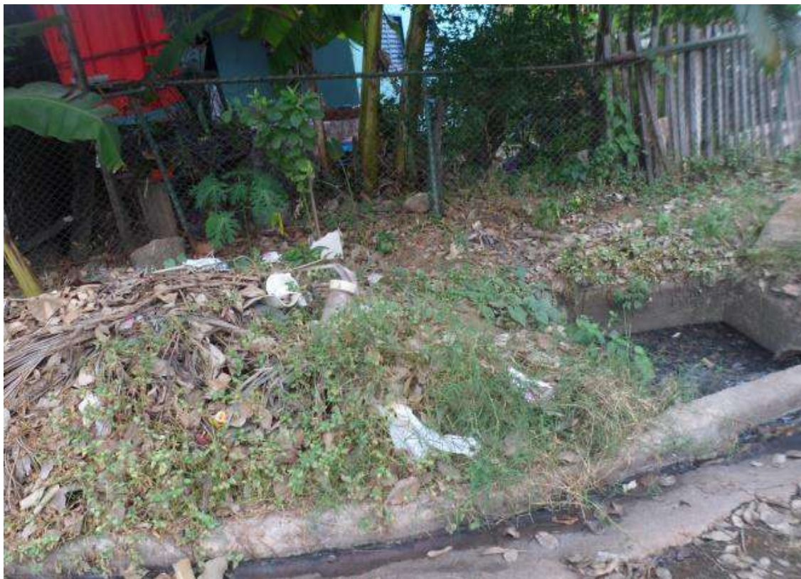
Figura 29 – lançamento de esgoto e tubulações entupidas, alguns dos problemas socioambientais diagnosticados pelos estudantes no bairro Lagoa do Jacaré.
