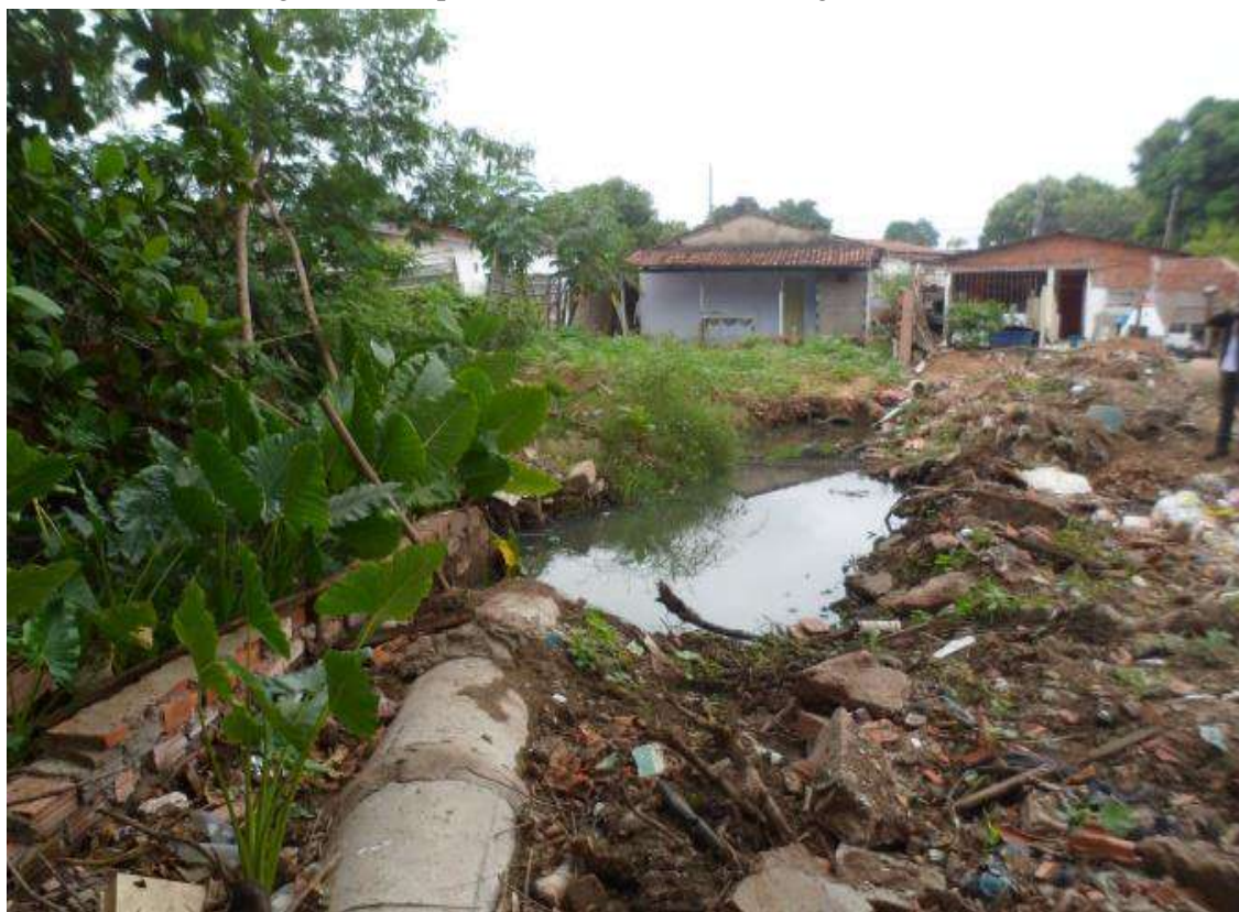
Figura 28 – Tubulações rompidas e esgoto a céu aberto, um dos problemas socioambientais diagnosticados pelos estudantes no bairro Lagoa do Jacaré.
