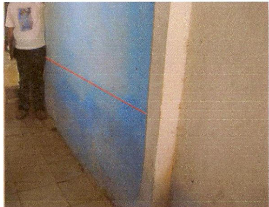
Figura 19 – Marca da enchente, resultado de inundações.
