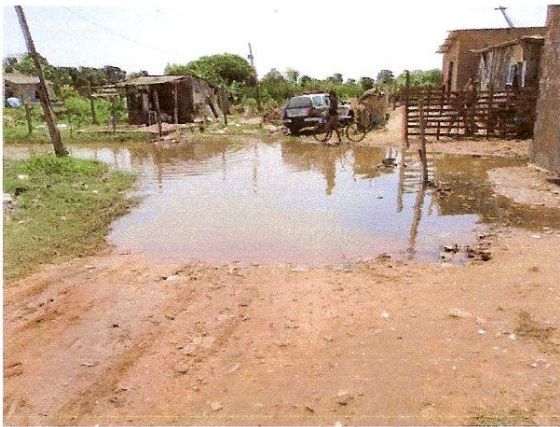
Figura 18 – Rua alagada com chuva do dia interior.
